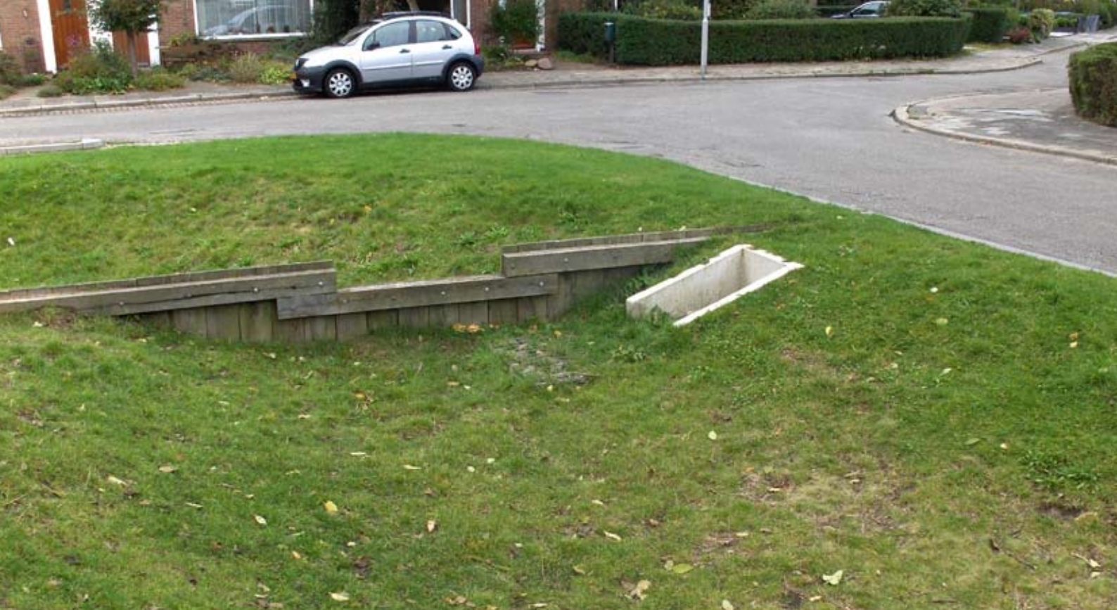
Voorbeeld van een wadi als infiltratievoorziening
